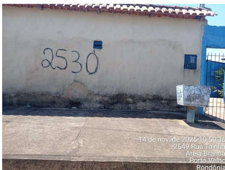
Foto 026: Rua Tainha - Manchas escuras na parede (chorume/resíduos)
