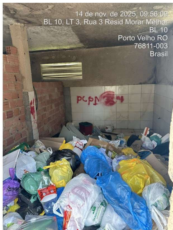
Foto 02: Morar Melhor, Bloco 10 - Lixeira improvisada vazia
